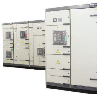
Tủ điện hạ thế, tụ bù
